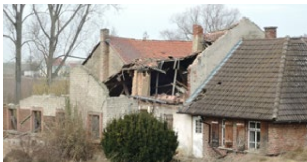
Gebäude zerfallen ungenutzt.
